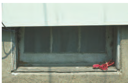
Antes: Ventana del sótano de madera vieja
