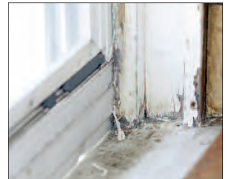
Abriendo y cerrando constantemente Muele polvo de plomo
